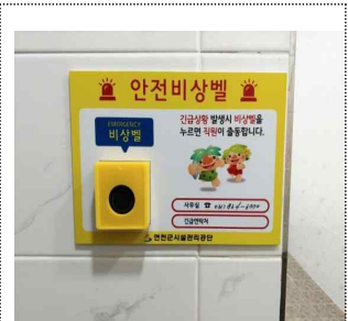
(예시) 안전비상벨 설치
