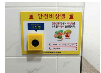
(예시) 안전 비상벨 설치
